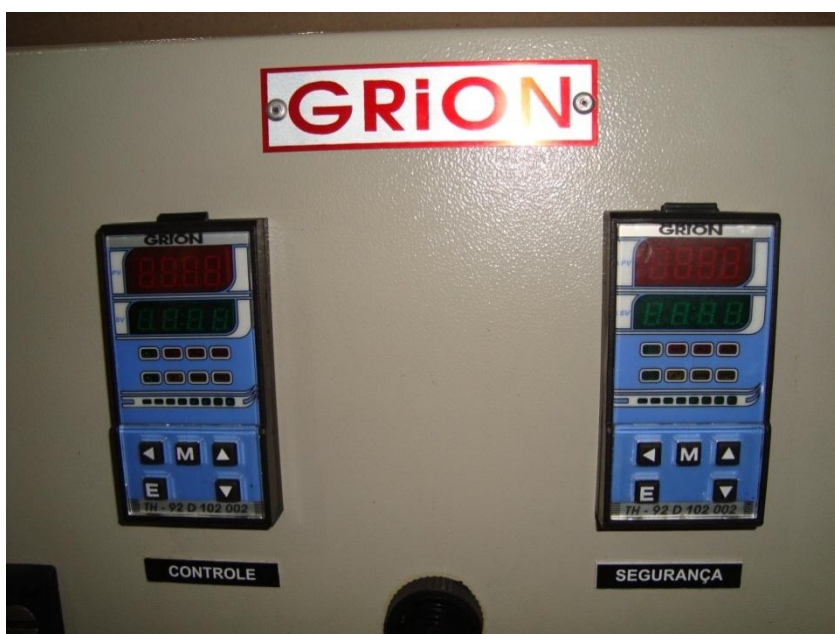
Figura 70 - Foto frontal dos controladores instalados na caixa de controle do forno
