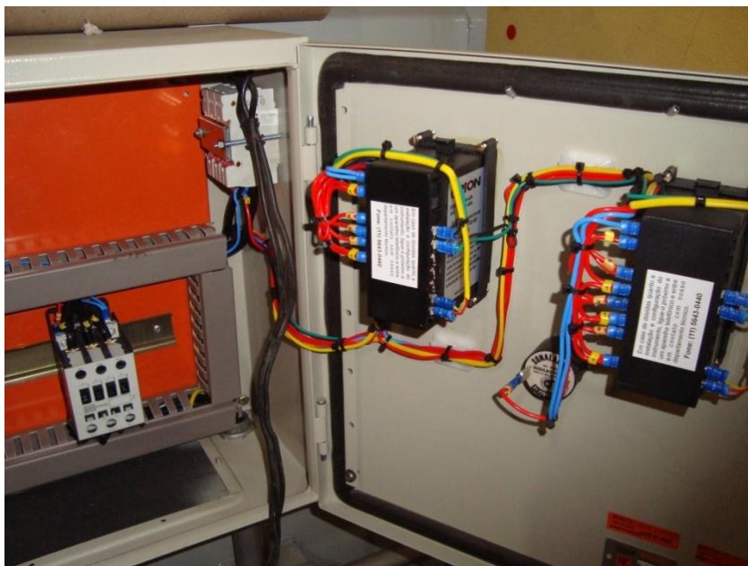
Figura 69 - Detalhes de conexões dos controladores
